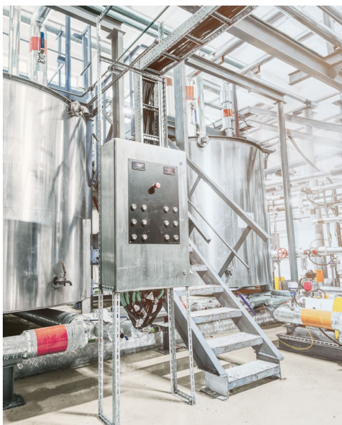
Industrielle Anlagen wie diese müssen nach den AwSV-Standards verankert werden.
