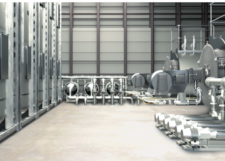
Eine Chemie-Produktion mit Tanks und Rohrleitungen ist ein Beispiel für HBV-Anlagen.
